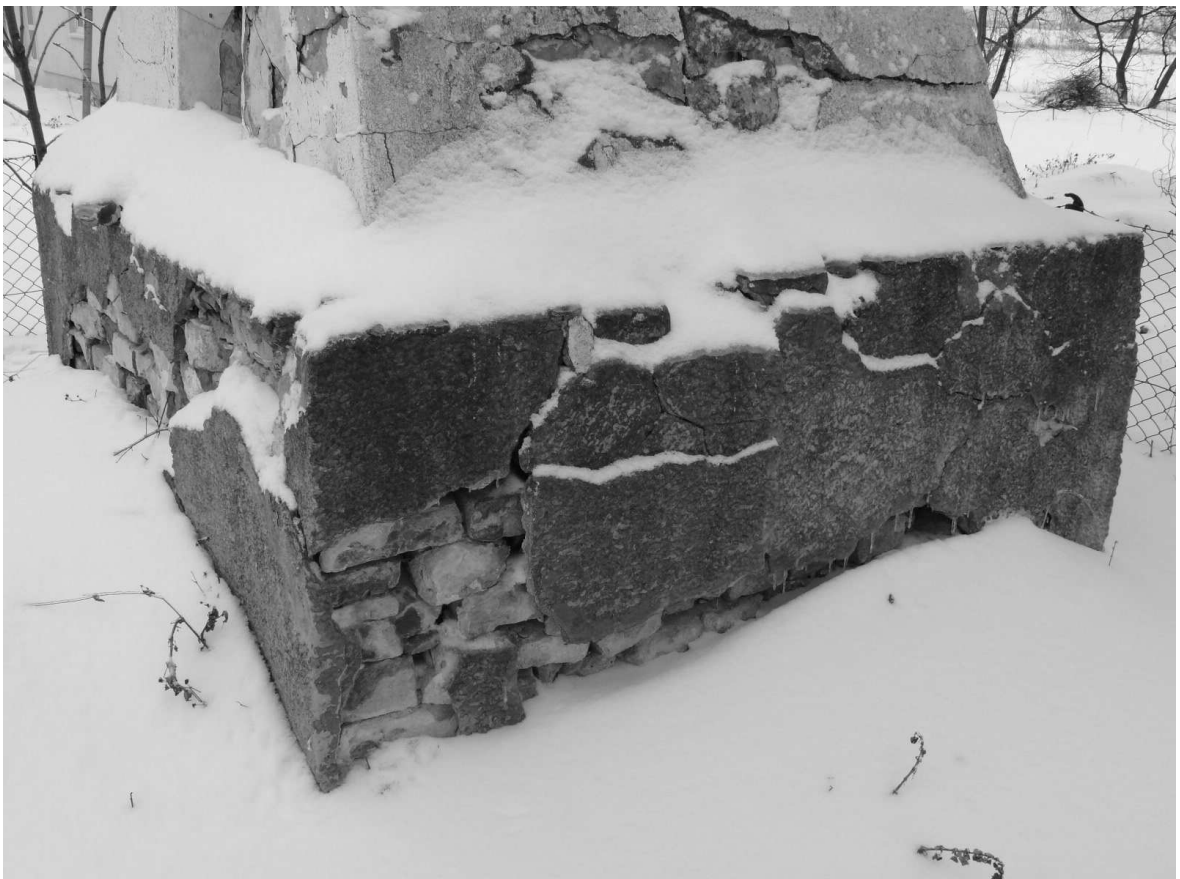
Fot. nr 2 – widok zniszczeń cokołu
